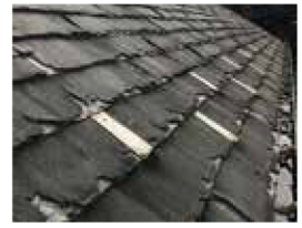
スレート屋根の割れ、色あせ
