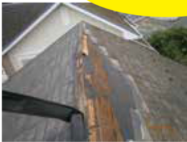
台風によりスレート棟が飛んだ
