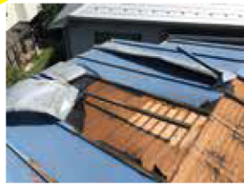
築 15 年、強風で屋根が剥がれた 金属立て葺き屋根
